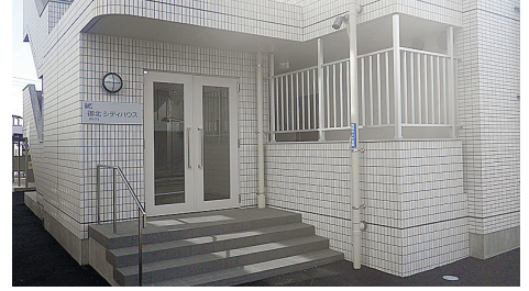
△基礎がかさ上げされたバルコニー(大進建設提供)
